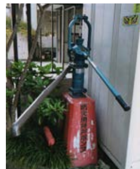
古井戸活用の 防災用手押しポンプ
